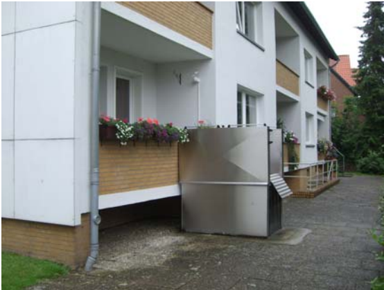
Außenhublift: ca. 10.000 € Wartungsvertrag bei Liften: jährlich 120 – 150 €
